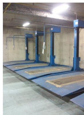
《機械式立体駐車場》
