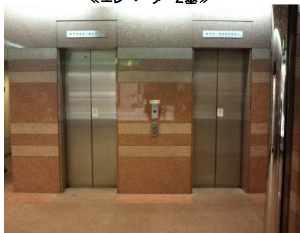
《エレベーター2基》
