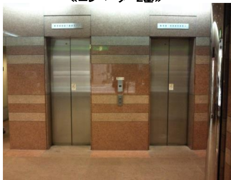
《エレベーター2基》
